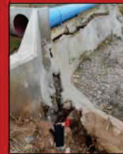
Día 28 de noviembre de 2016. Grietas en el camino de la acequia encima de la parcela.
